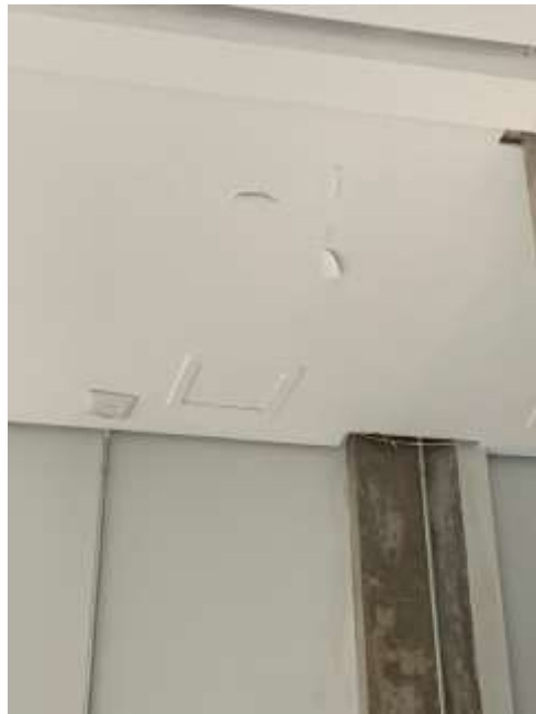
Figura 7 – Teto desgastado aproximação
