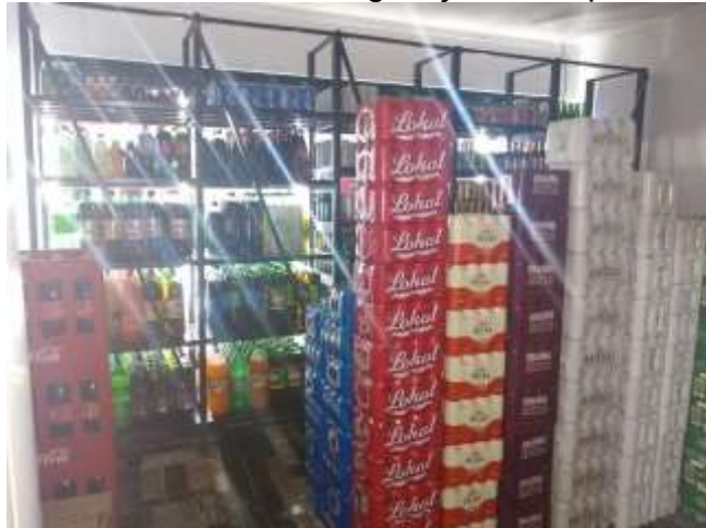
Figura 3 – Câmara de refrigeração do supermercado
