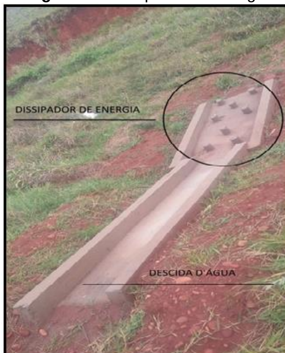
Figura 7 – Dissipador de energia
