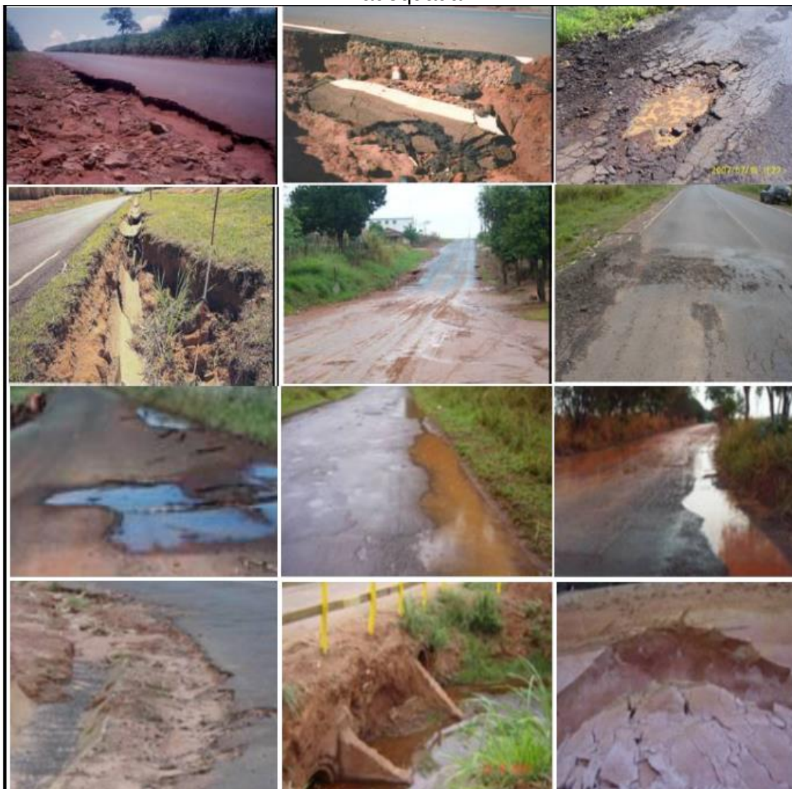
Figura 12 – Danos causados ao pavimento devido à drenagem superficial inadequada
